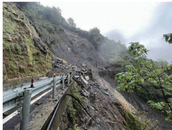
圖 1-25、台 7 線 49.8K 大曼路段崩塌阻斷通
